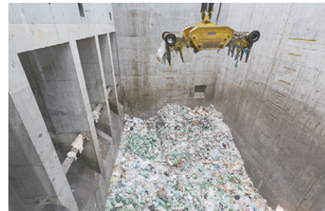
2 쓰레기 피트·쓰레기 크레인
